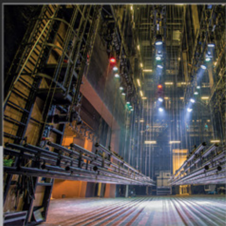
МЕХАНИЧЕСКОЕ ОБОРУДОВАНИЕ СЦЕНЫ И СИСТЕМЫ УПРАВЛЕНИЯ
